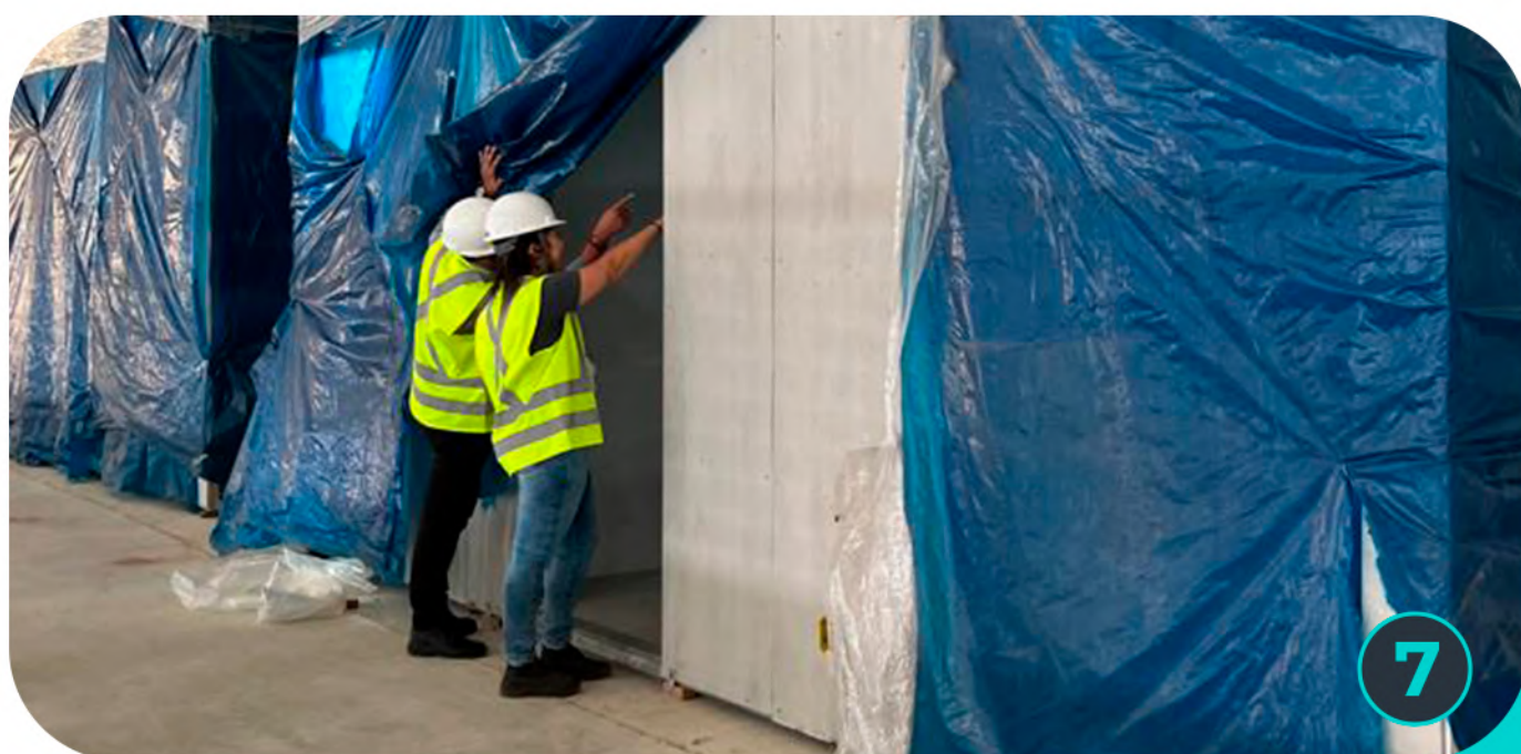
Equipe Matec e os Módulos Sanitários na obra HSI Syslog Cajamar (Fotos 6 e 7)
